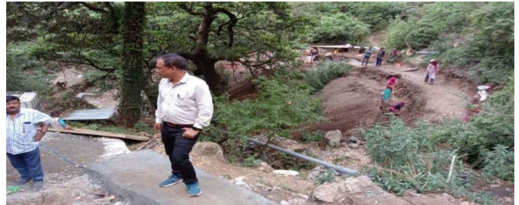
Arcedia STP 0.70 MLD
